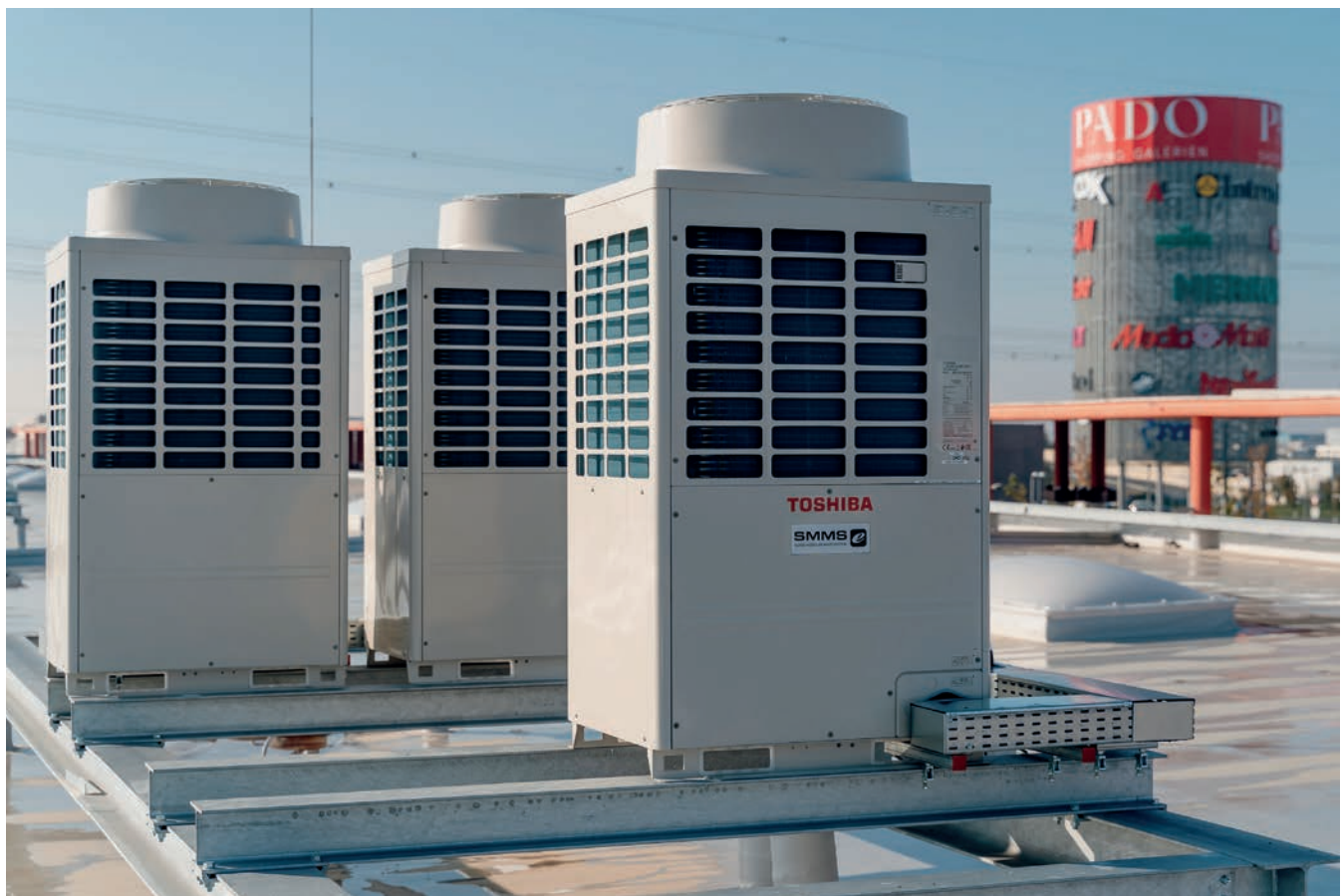
PADO Shopping Galerien Parndorf, CAVERION Österreich GmbH Klimaanlage und Wärmepumpen
