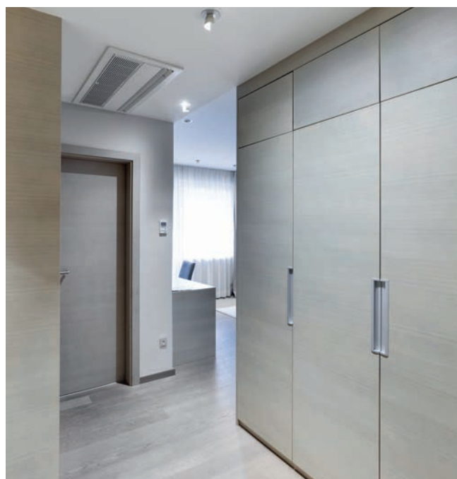
Gesundheitszentrum Park Igls Innsbruck, EDMUND SPARER Klima & Kältetechnik GmbH
