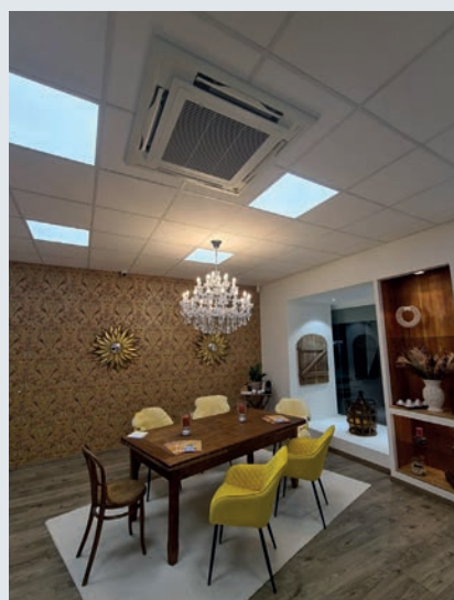
Handyshop Mureck, Cool Company Kälte - Klima - Gastro
