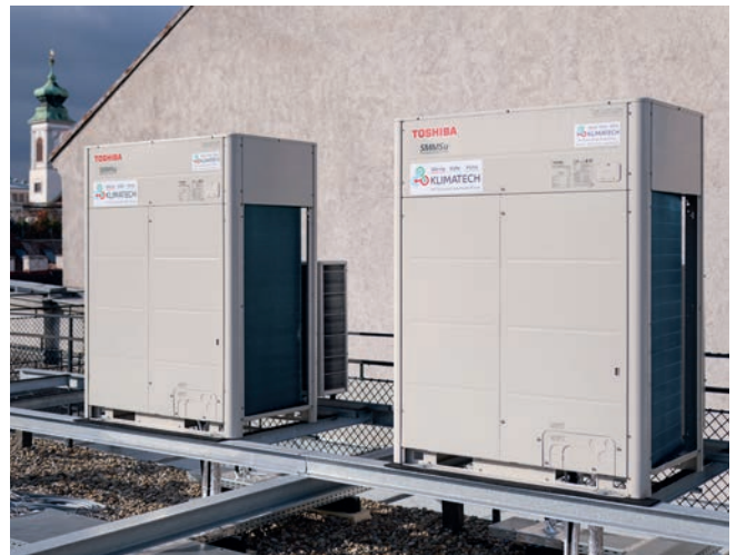
Büros und EDV-Räume Windmühlgasse Wien, Klimatech Wärme Kälte Klima
